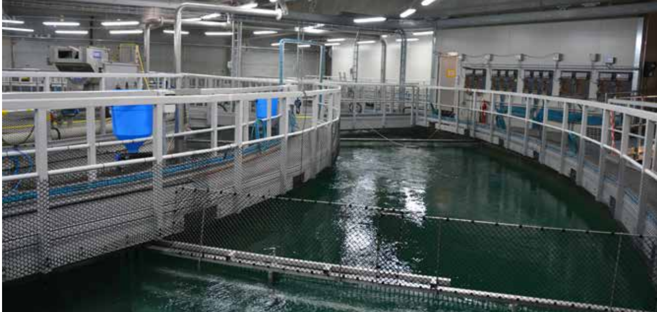
Veduta interna di impianto RAS
